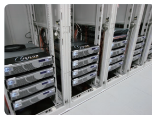
データセンターに格納されたアイシロンのIQシリーズ。青く光るLEDはクラスタ化して動作していることを示す
